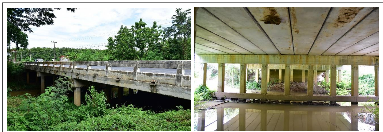
รูปที่ 7.4-2 ตัวอย่างรูปแบบสะพานระบบพื้นสำเร็จ (Precast Plank Girder)
